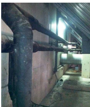
toile bitumineuse amiantée sur canalisation
