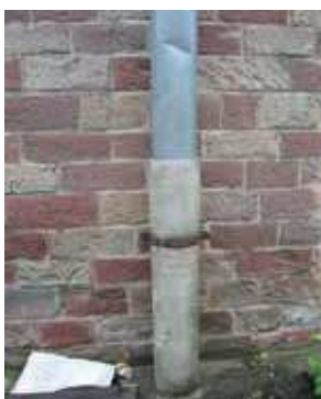
Eaux usées et pluviales
